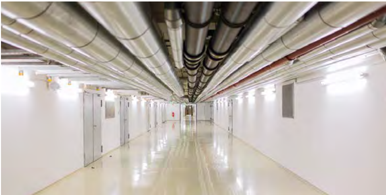
Richtungsweisend: Versorgungsleitungen für die energiesparende und umweltschonende Technik des Parlamentsviertels.
